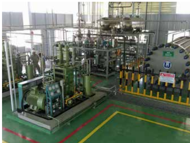
▲ Installation de production et de compression pour 500 Nm 3 /h (électrolyseur, séparateurs, purificateur, compresseurs)
