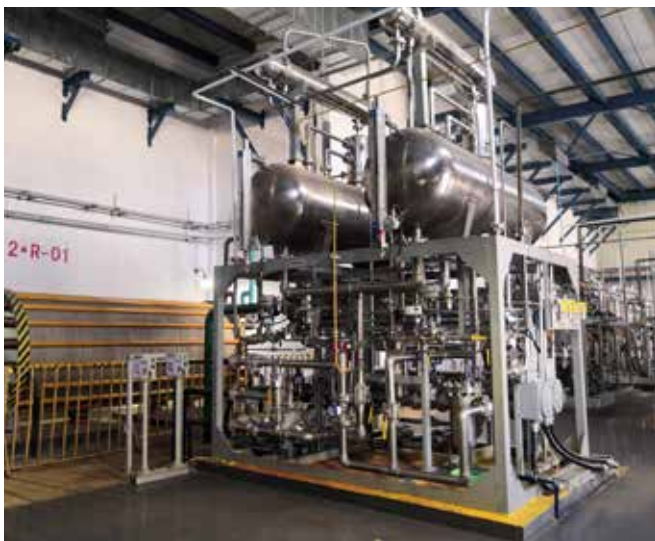
▲ Unité de 10MW avec 2 électrolyseurs de 5MW
